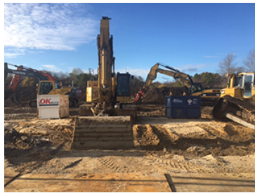
Gravemaskinerne står klar til at gå i gang med det nye byggeri, som Vestforbrænding skal levere fjernvarme til.
