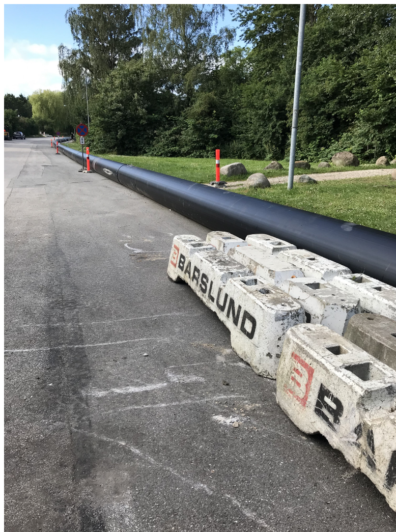
Ø630 regnvandsledningen "slanger sig" ned ad Ejby Mosevej, og bliver stykke for stykke trukket over til CMC-grunden.
