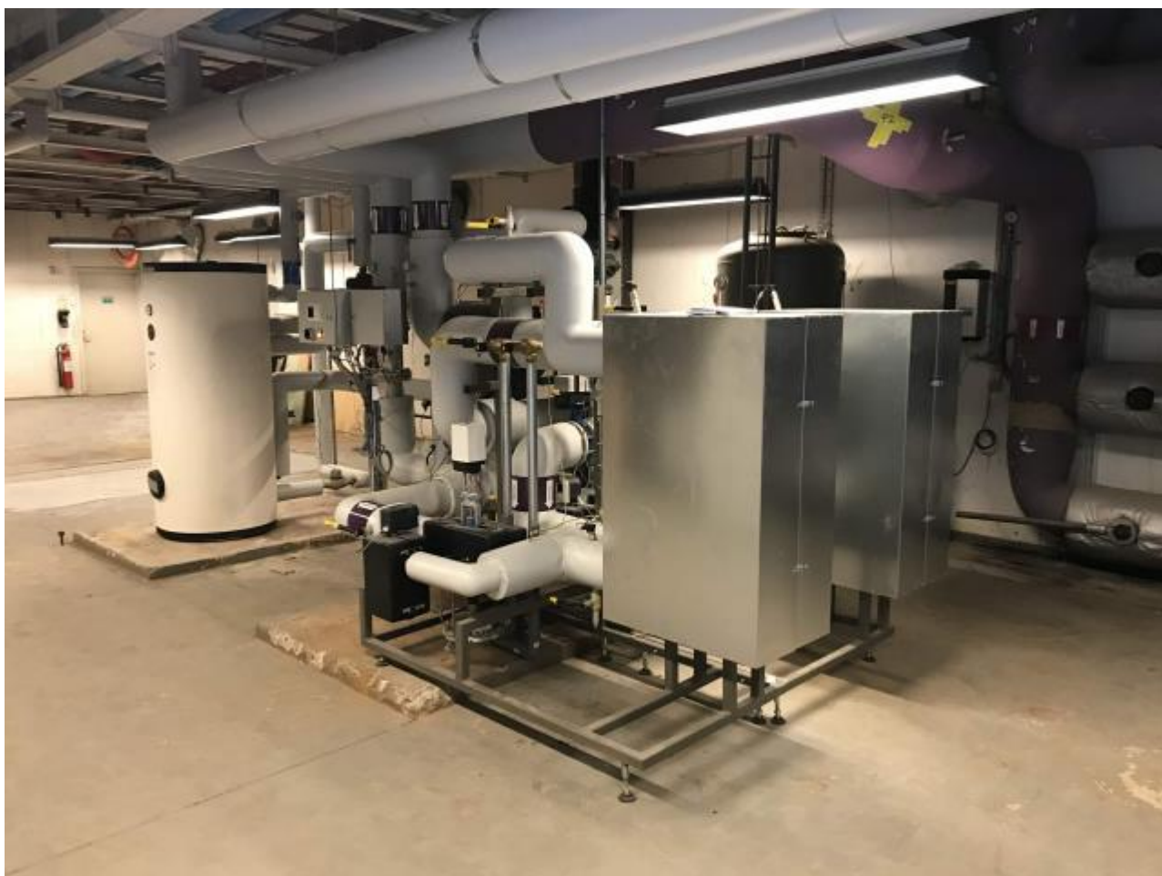
En af de seks fjernvarmeunits, som Haldor Topsøe har fået installeret.
